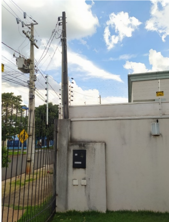
Foto 4 – Entrada de serviço em baixa tensão existente
