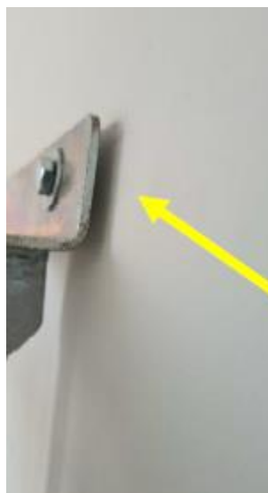
Imagem 3 - Situação após 24hs (deslocamento de 6mm).
