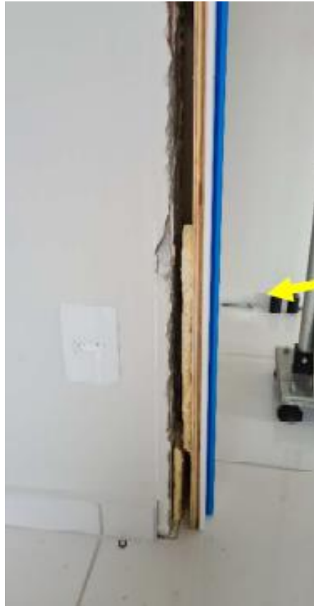
Imagem 11 – Desprendimento do batente da porta.
