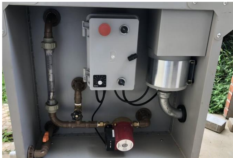
Imagem 14 - Sistema de ventoinha, tubulação, reguladores de pressão e acumulação de água.
