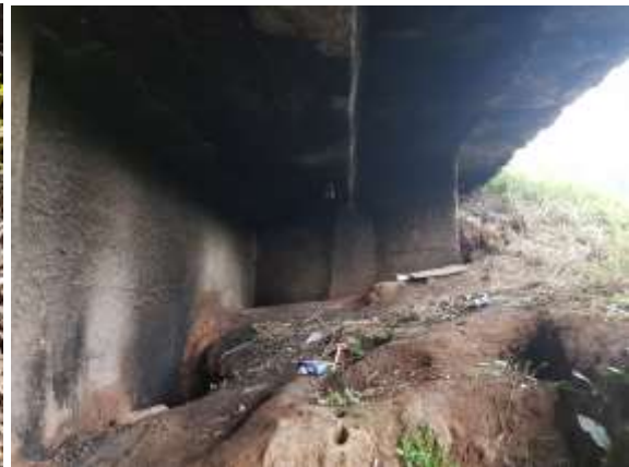
Imagem 21 – Mancha de fogo na laje, longarina e encontro
