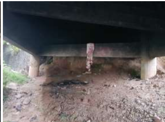
Imagem 25 – Mancha de fogo no encontro.
