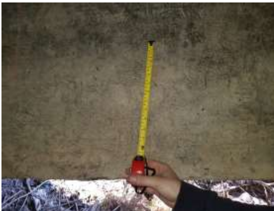
Imagem 42 - Fissura na viga longarina
