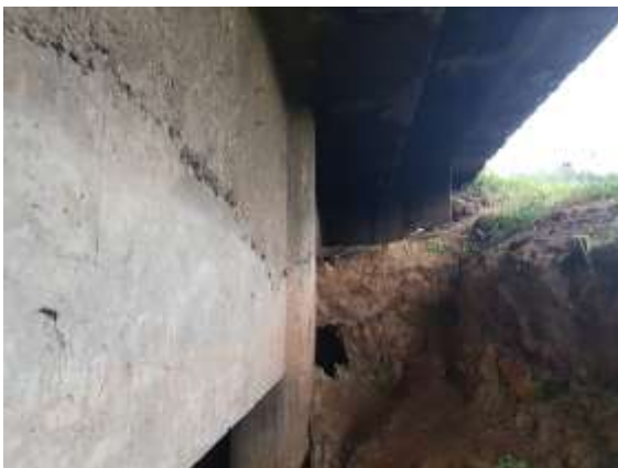
Imagem 22 – Erosão e mancha de fogo no encontro
