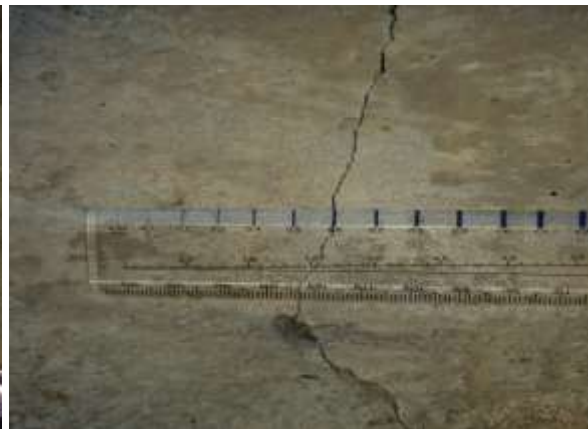
Imagem 43 - Fissura na viga longarina
