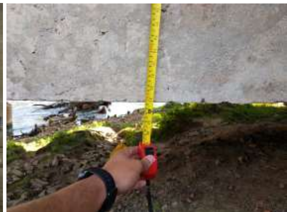
Imagem 45 - Fissura na viga longarina
