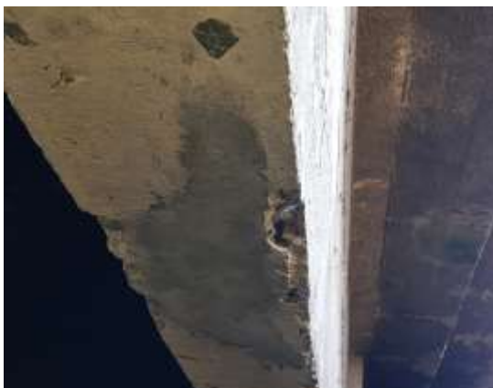
Imagem 26 – Deslocamento na viga longarina
