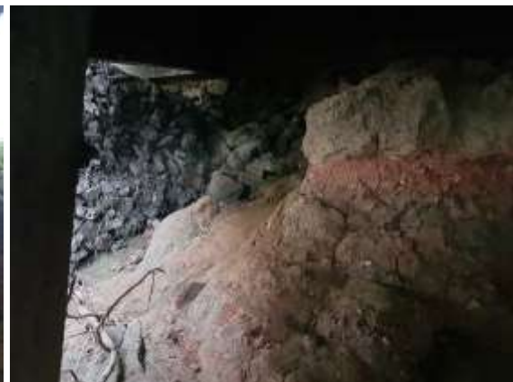
Imagem 23 – Erosão no encontro
