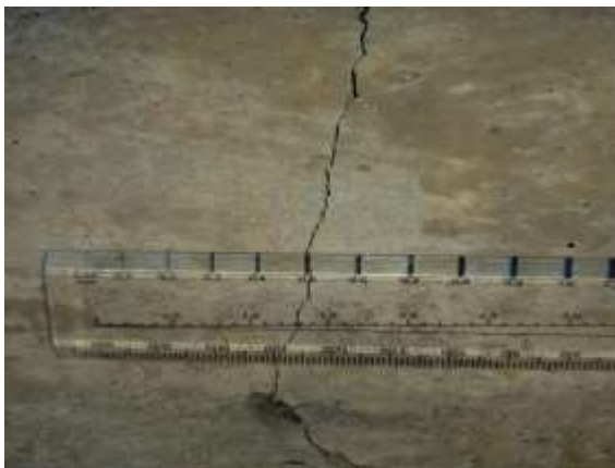
Imagem 44 - Fissura na viga longarina
