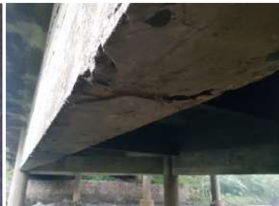
Imagem 27 – Deslocamento na viga longarina
