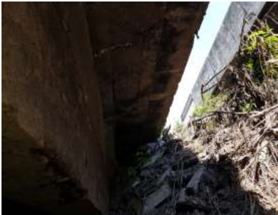
Imagem 20 – Deslocamento na laje
