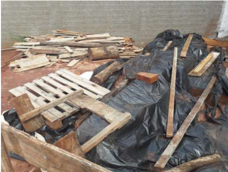
Imagem 18 – Sobras de madeira espalhados pela obra
