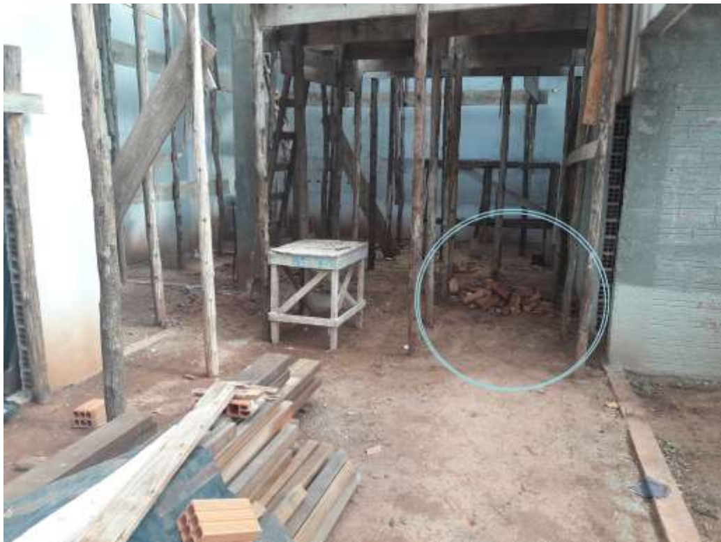
Imagem 21 – Sobras de madeira espalhados pela obra
