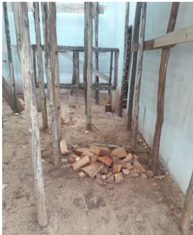
Imagem 20 – Sobras de madeira espalhados pela obra
