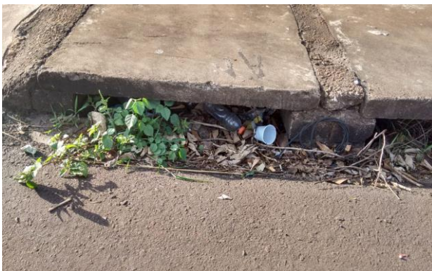
Foto 7 – Boca de lobo obstruída por lixo
