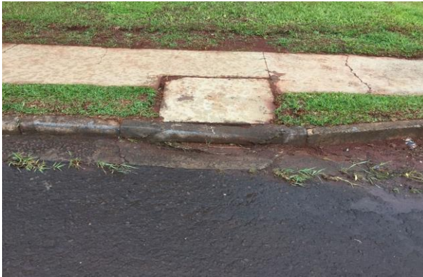
Foto 5 – Boca de lobo sem manutenção
