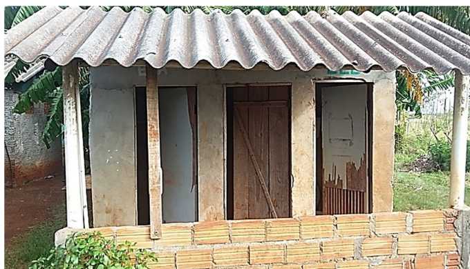
Figura 31 - Banheiros que atendem a 140 pessoas do Colégio Estadual do Campo Aprendendo com a Terra e com a Vida, localizado no Assentamento Valmir Motta de Oliveira, em Cascavel/PR
