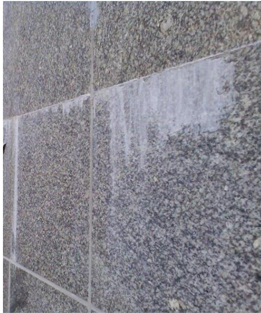
Foto 06: REVESTIMENTO CERÂMICO QUE POSSUI EFLORESCÊNCIA.
