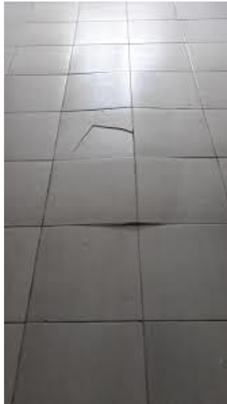
FIGURA 2: DESCOLAMENTO DAS PLACAS CERÂMICAS.
