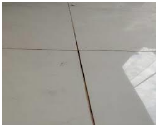
Figura 06: DETERIORAÇÃO DA JUNTA.
