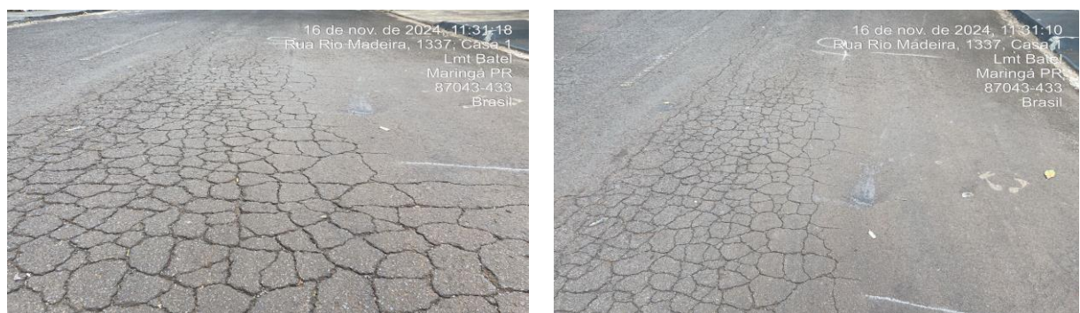
Figura 7 – Manifestação patológica: Trinca tipo “couro de jacaré”
