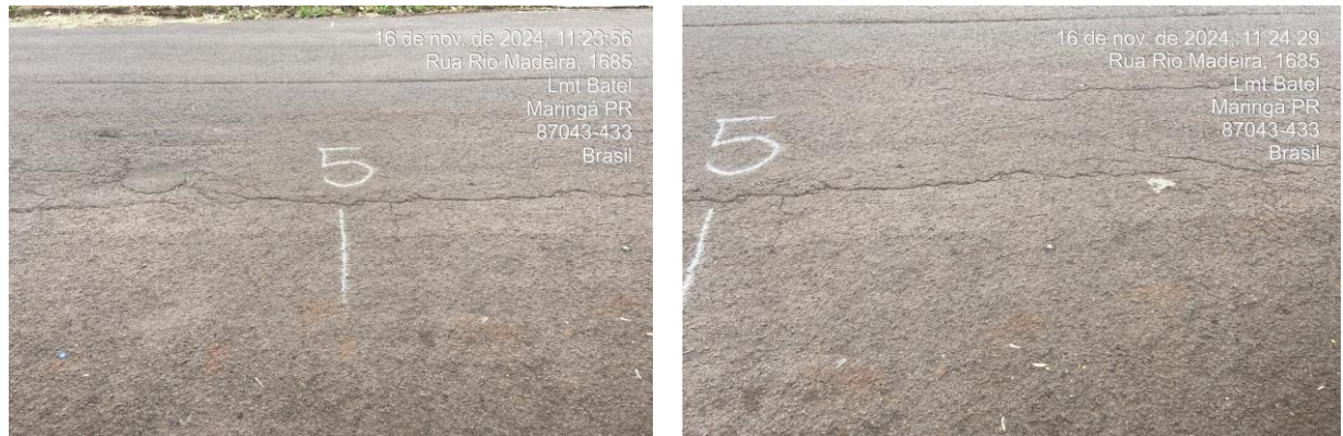
Figura 6 – Manifestação patológica: Trinca isolada
