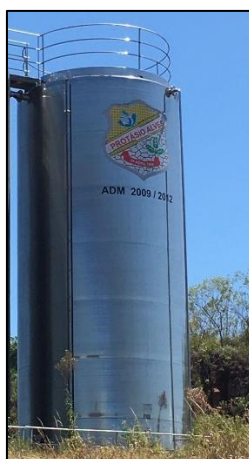
Figura 7 – Sistema de reservação do SAA Sede do M2 Fonte: Protásio Alves, 2022.
