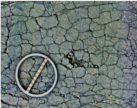
Figura 6: trincas interligadas – tipo “couro de jacaré”
