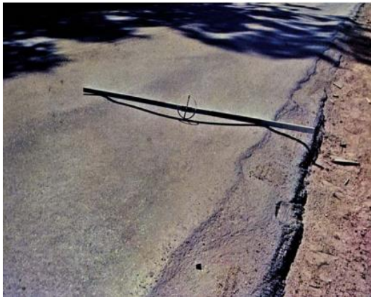
Figura 8: Afundamento de trilha de roda
