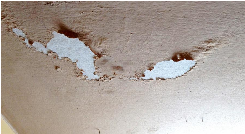
Foto 4 – Descascamento da Pintura
