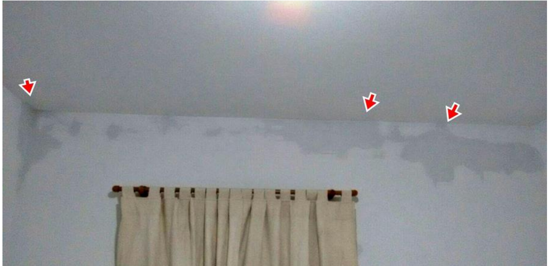
Foto 1- Manchas de umidade na parede
