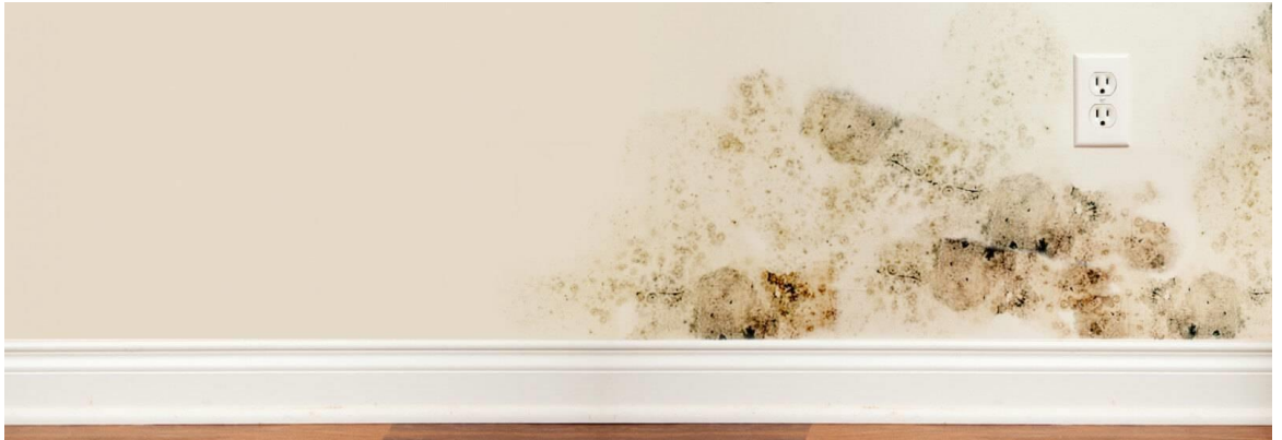
Foto 2 – Mofo próximo ao rodapé
