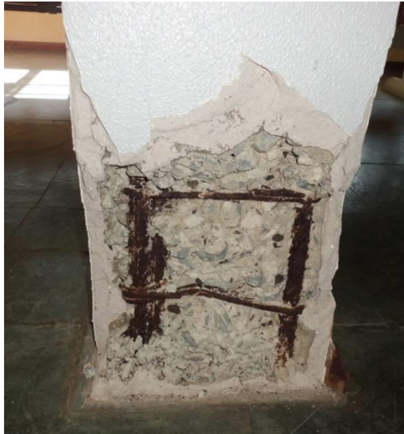
Foto 5 – Corrosão da armadura
