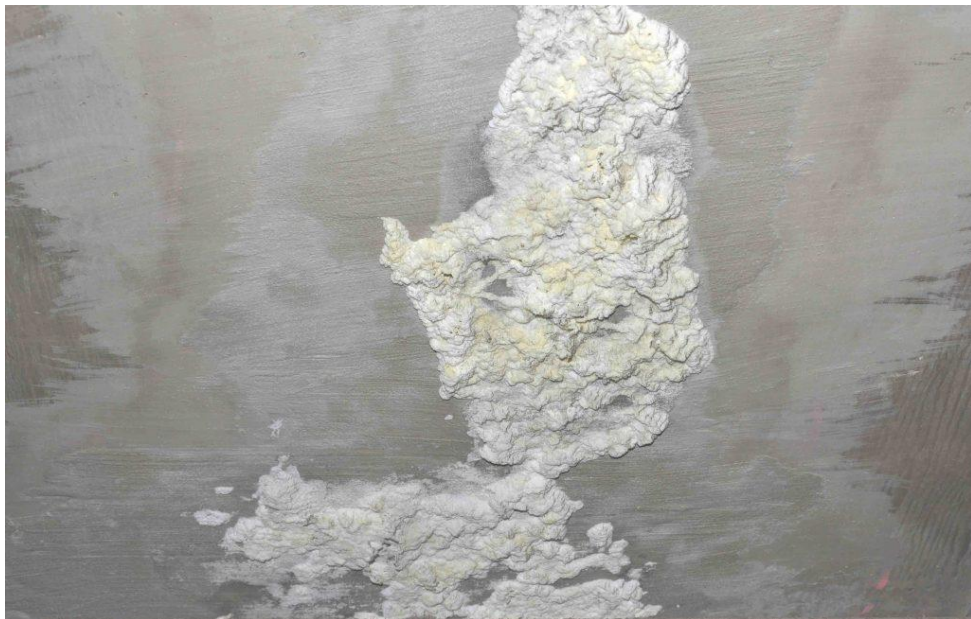
Foto 3 – Eflorescência na laje
