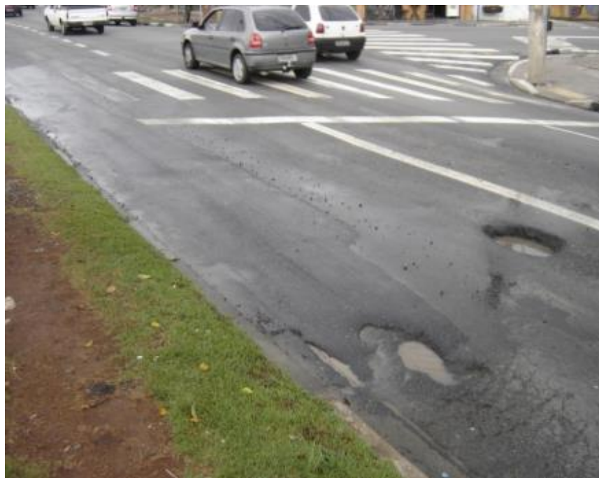
Figura 4: Exemplos de buracos em pavimentos asfálticos.
