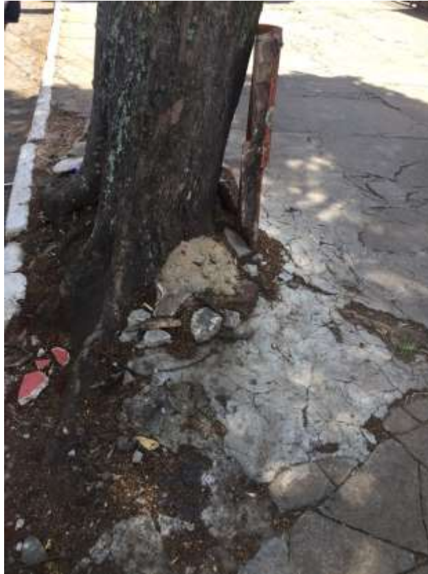
Figura 6: Sistema radicular da Caesalpinia peltophoroides danificando o passeio na rua do município de Mandaguari/PR. Fonte: O autor, 2019.
