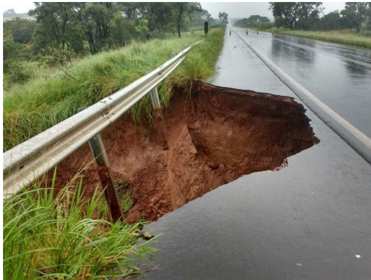
Figura 1 – Erosão atingindo a rodovia.
