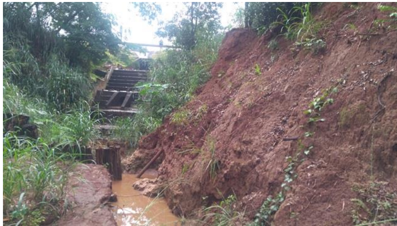
Figura 2 – Erosão em processo de recuperação natural da cobertura vegetal.
